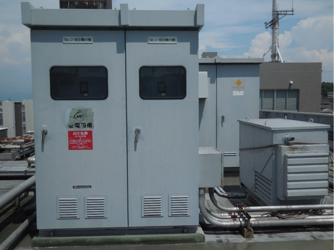
既設第2キュービクル（更新対象変圧器設置場所） 西側から撮影
