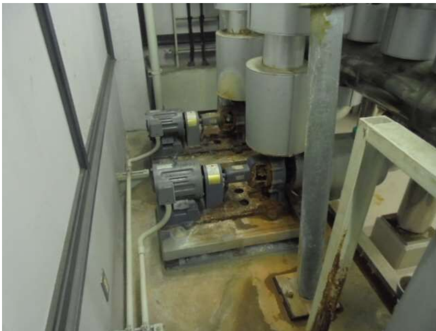
写真向かって奥側が冷温水機 2 次ポンプ (CHP-2-2) 設置室正面に積載制限 750Kg のエレベーター有り
